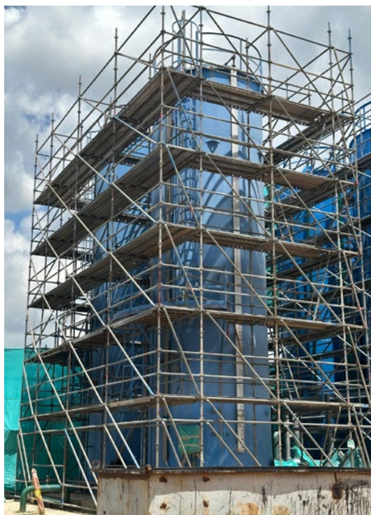
Figura 4. Uso seguro de andamios
