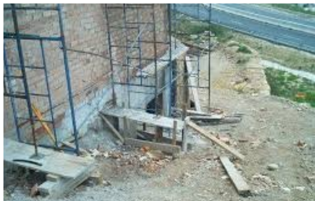
Figura 18. Andamio tipo modular de cruceta o “andamio para construcción”
